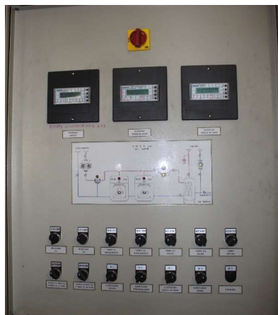
Figura 4.1 Quadro elettrico esistente
