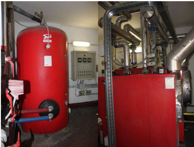
Figura 3.1 Vista interna di bollitore e generatori
